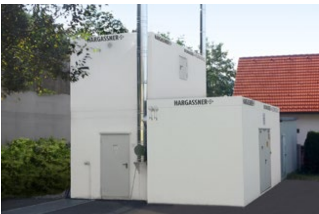
Dreifachstock-Heizmodul bei Gastronomiebetrieb.
