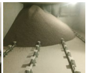
Lagerraum für 120 t Pellets
