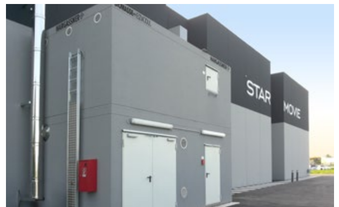
Doppelstock-Hackgut-Heizmodul neben öffentlichem Gebäude.
