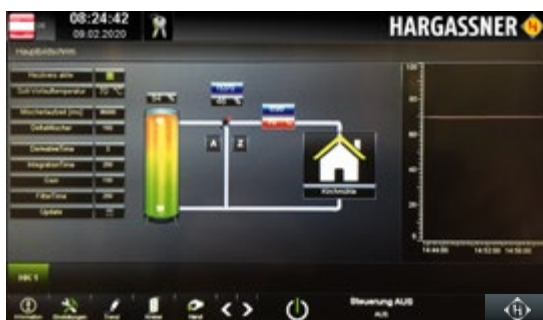
Regelung externer Gebäude
